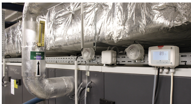
CP210-R nella sala trattamento aria di un sito industriale.
