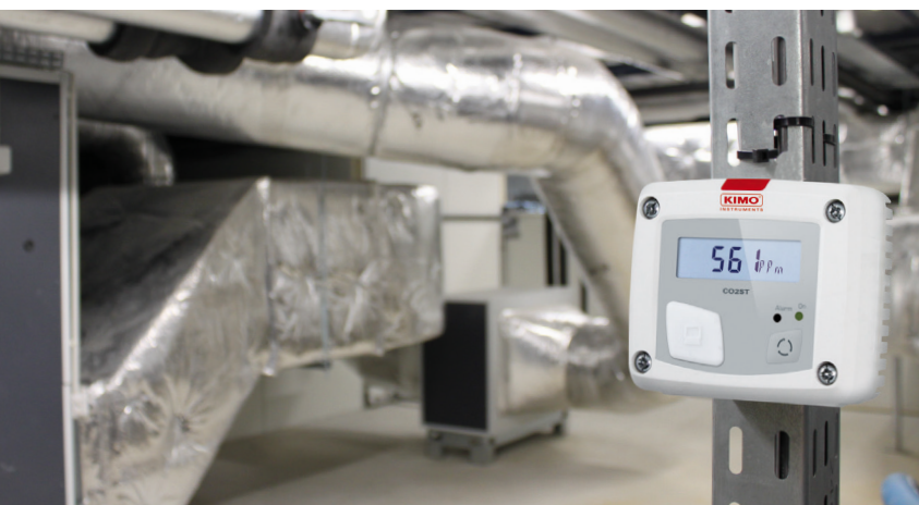
CO2ST montato nell'unità di trattamento aria di un sito industriale.
